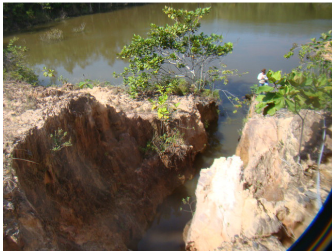
Figura 1: Voçoroca na rodovia AM-010, km 46.
