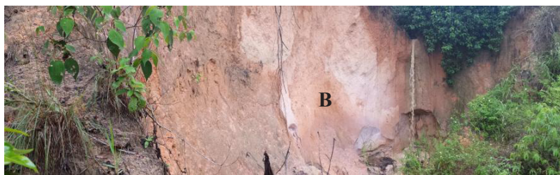
Figura 05: Voçoroca 4, km 12,1, BR174.
