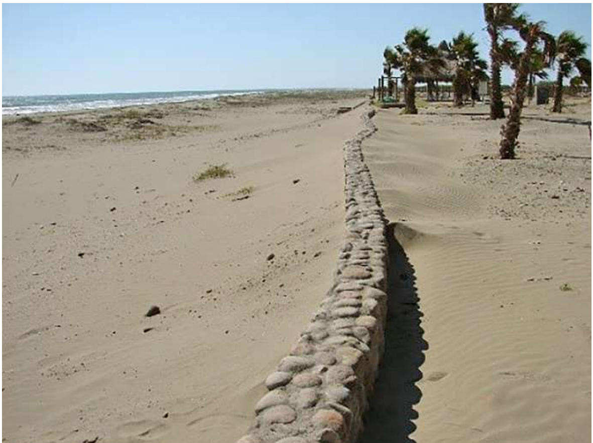
Figura 2.1. Dunas frontais defronte à retropraia com muro de contenção. Novo Altata, Sinaloa, México.
