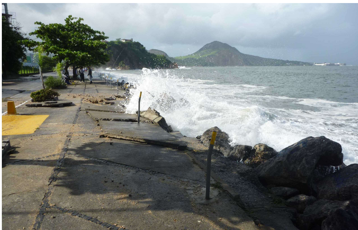
Figura 29.14. Exemplo de galgamento das ondas ( overtopping ) em muro de enrocamento com destruição de benfeitorias durante evento de ondas de tempestade em abril de 2010. Baía de Guanabara, Niterói, RJ.
