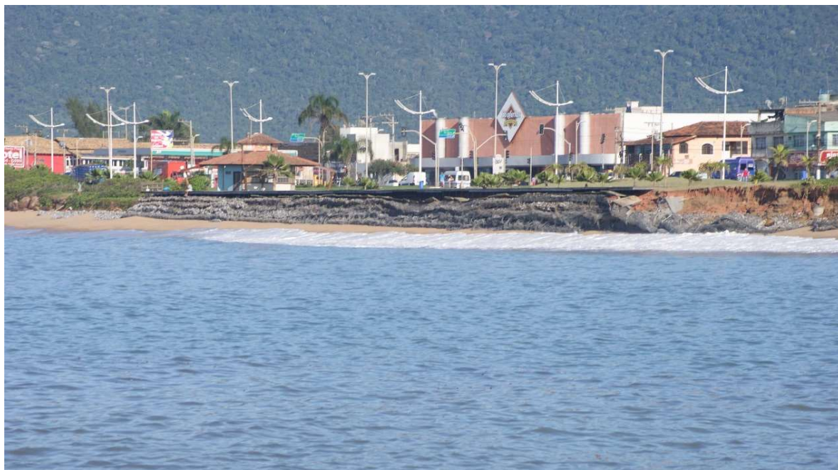
Figura 29.13. Exemplo de colapso de estrutura do tipo muro de gabião na praia da Tartaruga, Rio das Ostras, RJ.
