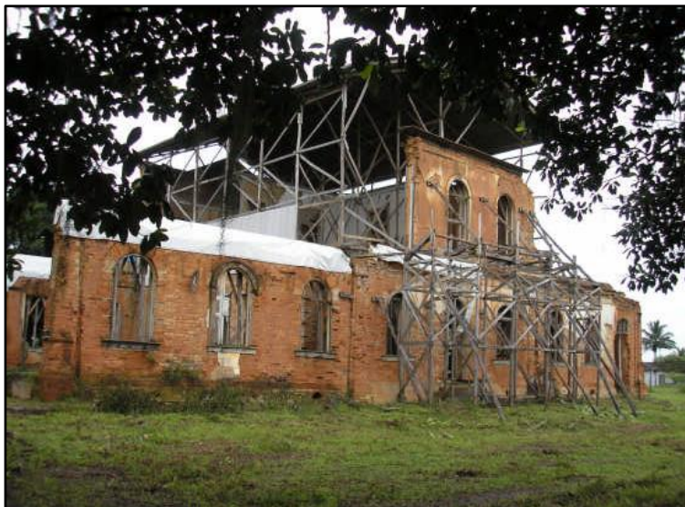
Figura 3: Ruínas da Sede da Fazenda de Machadinha
