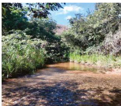
Fotografia 4: Passagem de água na estrada
