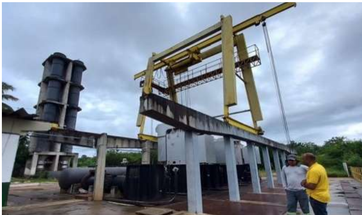
Foto 1 – Infraestrutura hidráulica do Projeto Público de Irrigação Formoso
